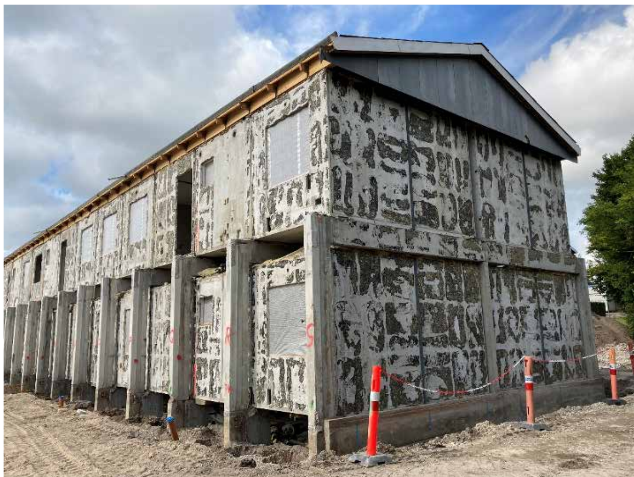
Facaderne er nedbrudt, og tilbage står de rå elementer, samt boxsystemet.
