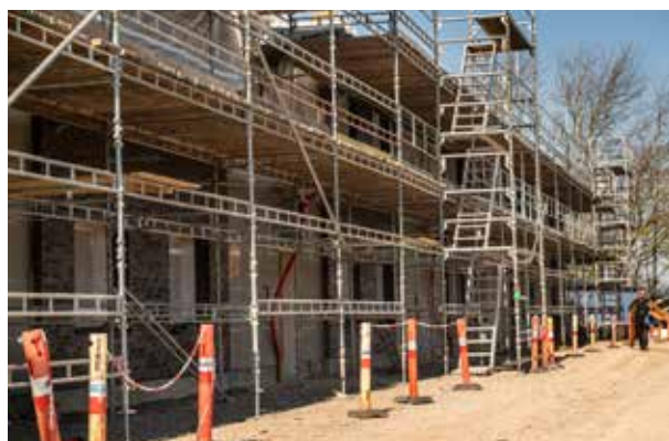
Facaderne er nedbrudt, og tilbage står de rå elementer, samt boxsystemet.
